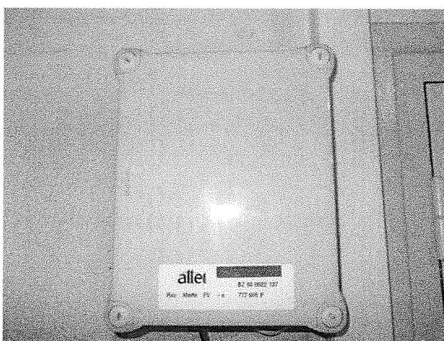
Coffret FT à déposer
